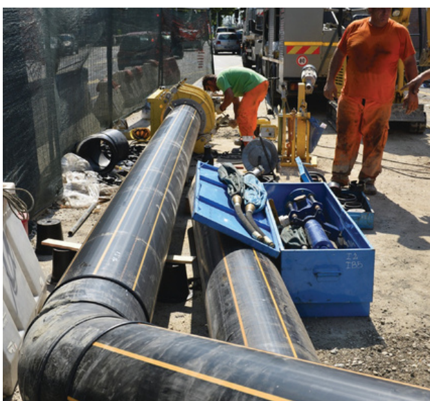
Exemplo de instalação no local. Cidade de Pádua - Itália.
